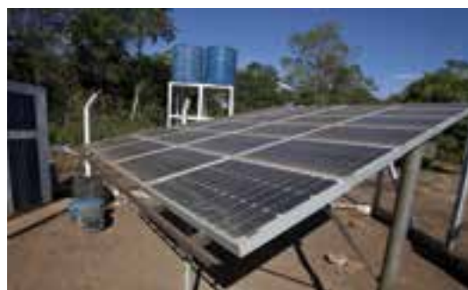
Painéis de energia solar.
